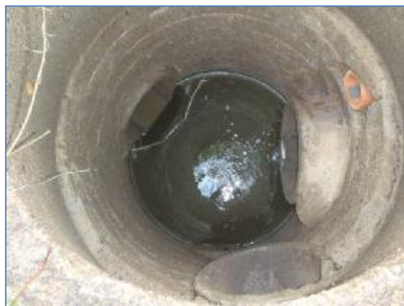
Afløb fra Overby, Brønd D st. 224
