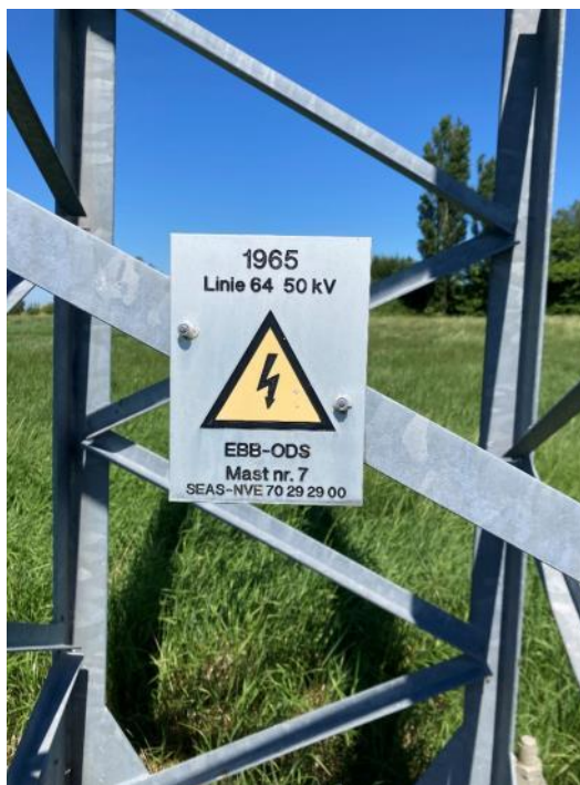
Figur 23: Eksempel på højspændingsmast som er registreret i undersøgelsesområdets østlige del.
