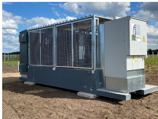
Figur 1-5 Eksempel på en transformer, der placeres inde blandt solcellepanelerne.
