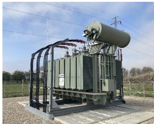
Figur 1-6 Eksempel på power-transformer, som typisk placeres midt i anlægget langt væk fra naboerne. På billedet anes også lynafleder som tynd, hvid mast (ikke at forveksle med højspændingsmast med ledninger).
